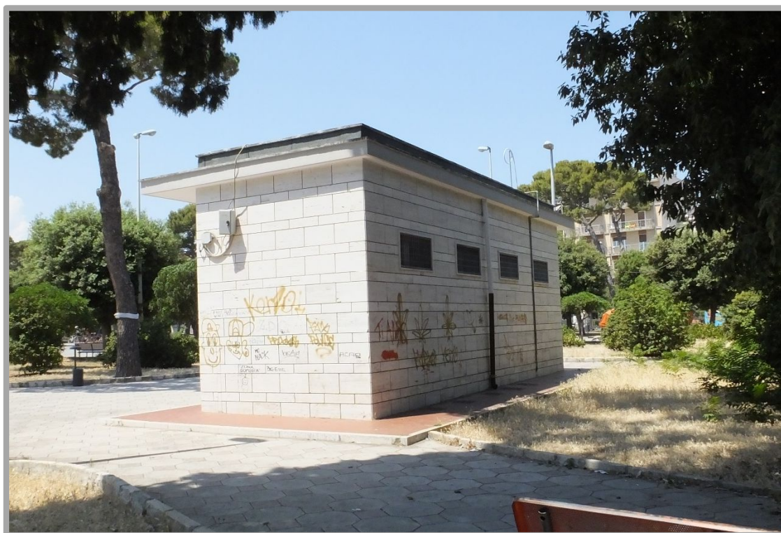
Fig.04 - Blocco servizi - degrado antropico del paramento
