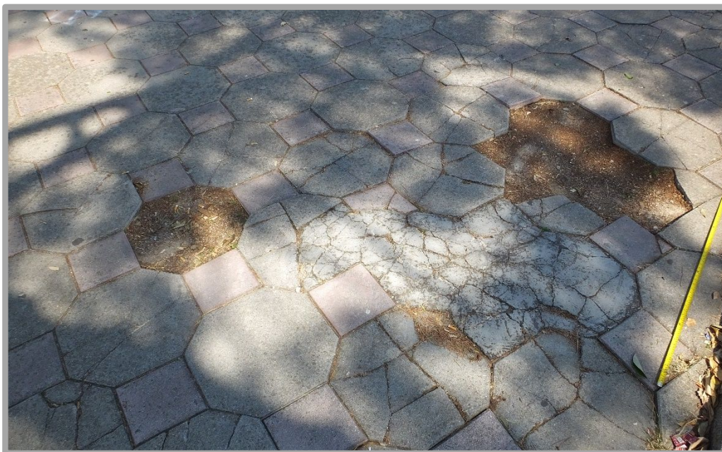
Fig.03 - Stato attuale della pavimentazione della Villa
